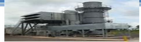
97 MW Avion First Gen/ IPP
